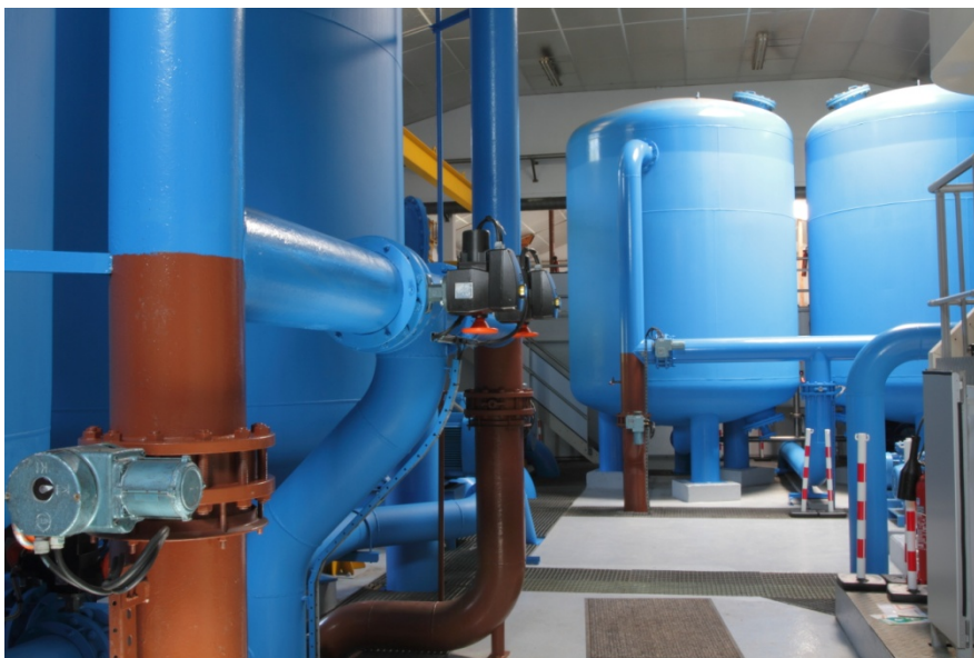
Filtres à charbons actifs en grains de la station des Bîmes
