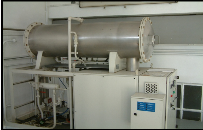
Ozoneur de la station des Bîmes (machine servant à fabriquer l'ozone)
